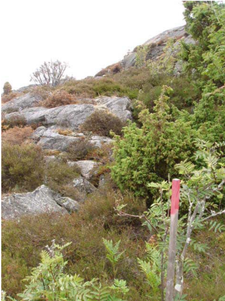
Foto 7: Utstakad planerad väg löper längs uppsprucken bergslänt.
