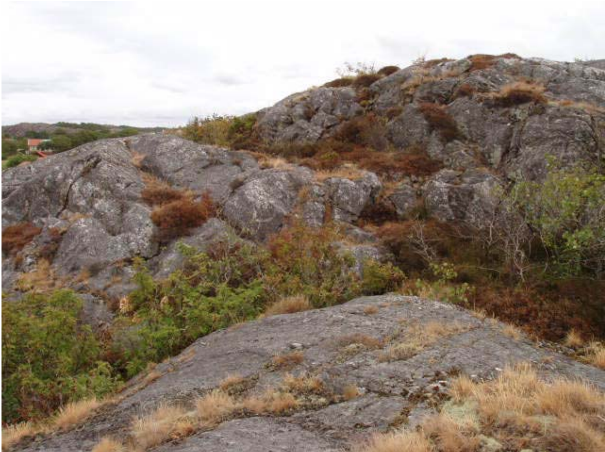
Foto 3: Instabil slänt ovanför vilken hus planeras byggas. Bergssidan är skivigt/blockigt uppsprucken och även på andra sidan hällen är berget brant och uppsprucket. På den sidan planeras ett hus under befintlig slänt.
